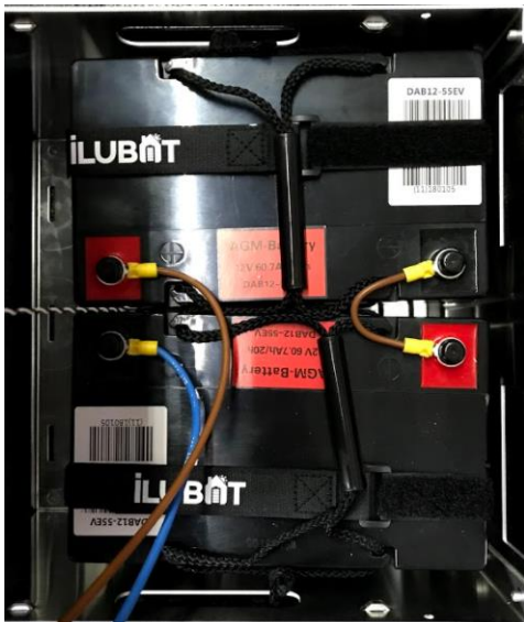
Overzicht batterijcompartiment na installatie batterijen
